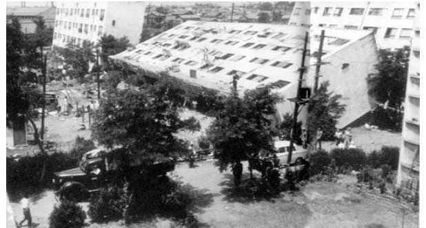
写真.1 大きく傾斜した県営アパート
